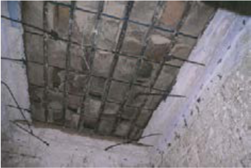
Bild: Brandprüfung einer Decke - nach dem Brand
