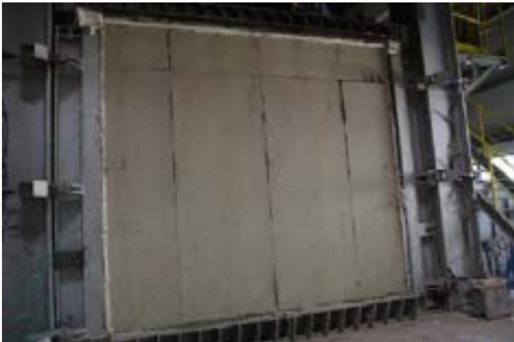
Bild: Brandprüfung einer Wand - nach dem Brand
